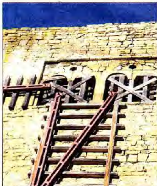
Der Palas der Lobdeburg-Ruine wartet weiter auf eine Sanierung Foto: Michael Groß
